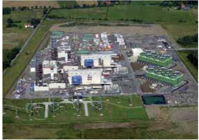
Erstes kommunales Gas- und Dampfturbinenkraftwerk der Trianel in Hamm-Uentrop im Bau, Stand Juli 2007, das am 26.10.2007 feierlich in Betrieb genommen wird; Quelle: Stuttgarter Luftbild Elsässer GmbH
