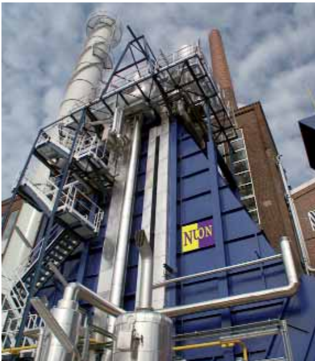
Mit diesem modernen Kraftwerk erzeugt Nuon Strom und Dampf in umweltfreundlicher Kraft-Wärme-Kopplung für die Unternehmen im Industriepark Oberbruch
